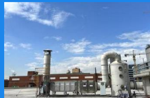
公司治理 VOCs减排装置
